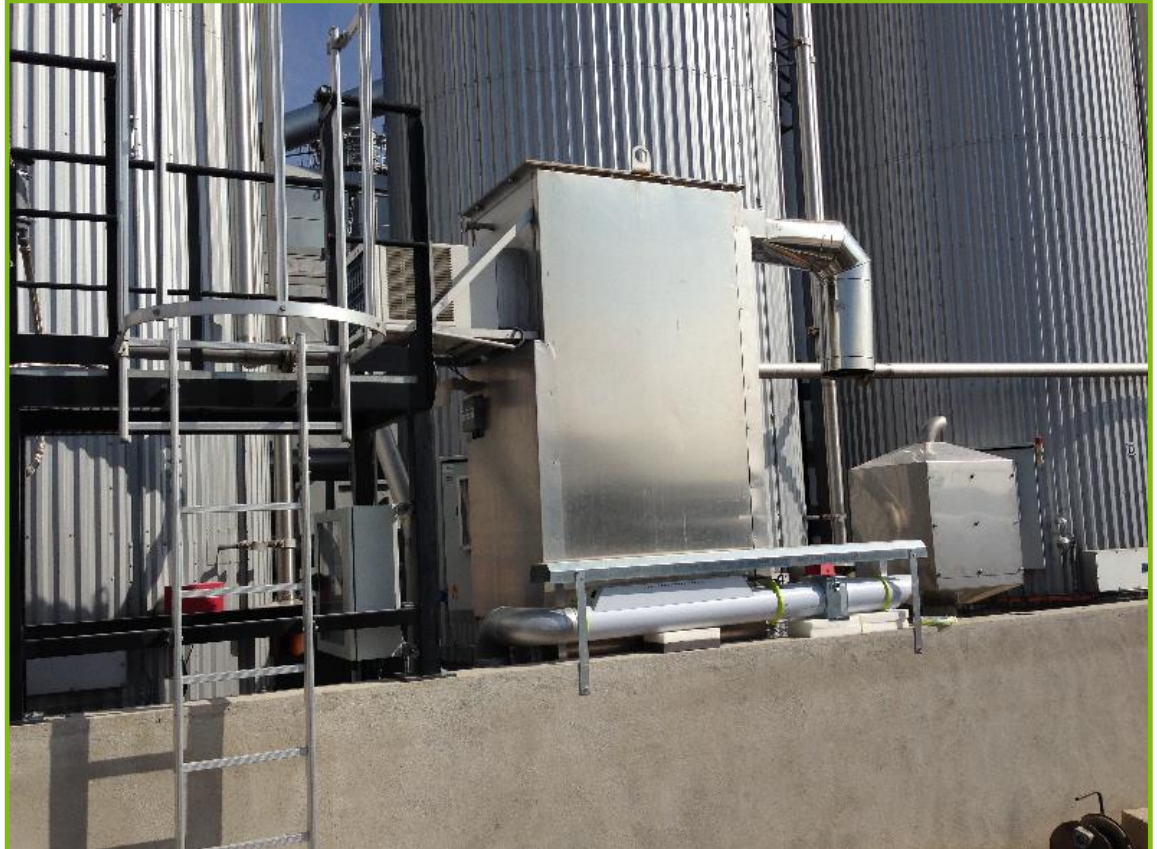
Geruchsreduktion, Asphaltwerk - Asphaltwerk Eiffage, Paris
