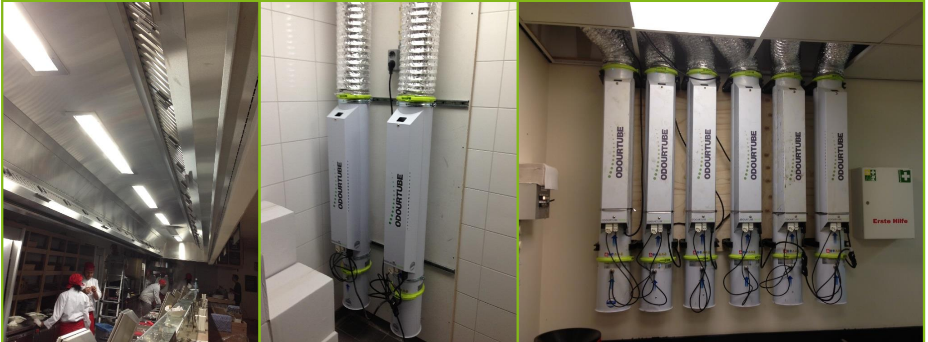
Vapiano II - Rotterdam, NL
